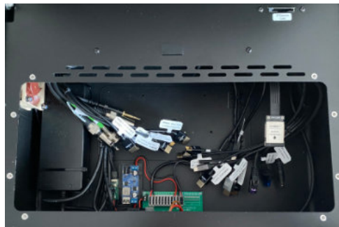
(Immagine 12) Fasci di cavi allo stato di consegna
