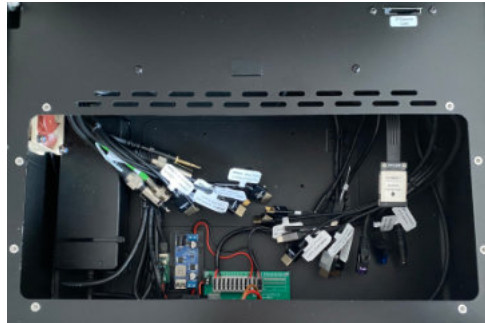
(Imagen 12) Mazos de cables en el estado de entrega
